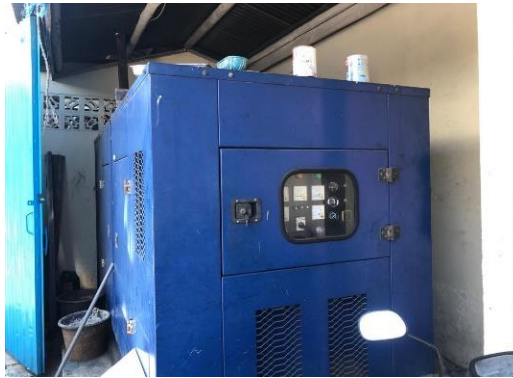
Gambar 4. Prasarana Instalasi Listrik CV Laut Jaya
